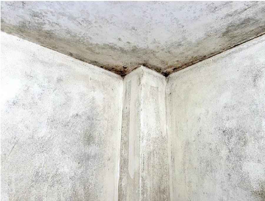
(1) Schimmelbildung nach Feuchteschaden in der Wohnung
